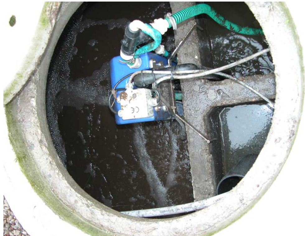
Foto 4: ATB Aquamax ® , links: SBR-Becken, rechts: Schlamm-speicher
